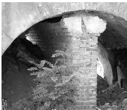
Ил. 6. Состояние арки 1-го пролета моста с элементами усиления, 2010 г.
